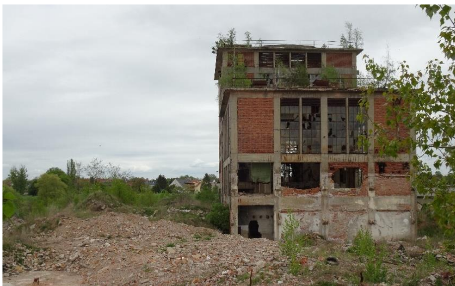
Abb. 15/16: Gebäude des Altwerkes der ehemaligen Zellstoff- und Papierfabrik Trebsen-Pauschwitz Fotos © Adrian
