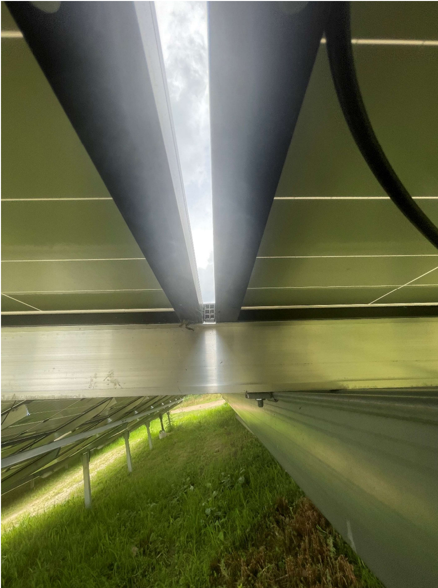
Abbildung 4: Lücken von ca. 2 cm Breite innerhalb der Modulflächen, durch die ebenfalls Niederschlagswasser auf den Boden gelangen kann
